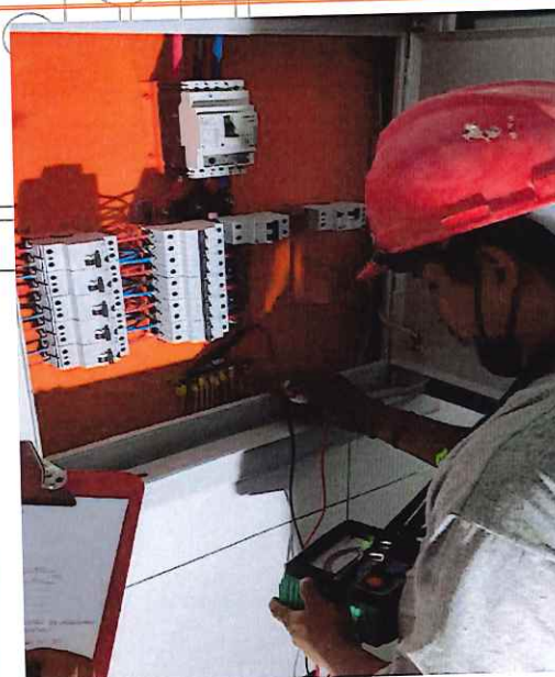
DETALLE: Pruebas de megado en tableros eléctricos
