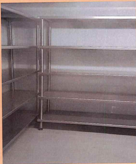
DETALLE: Presentación de estantes de acero inoxidable dentro de las cámaras frigoríficas
