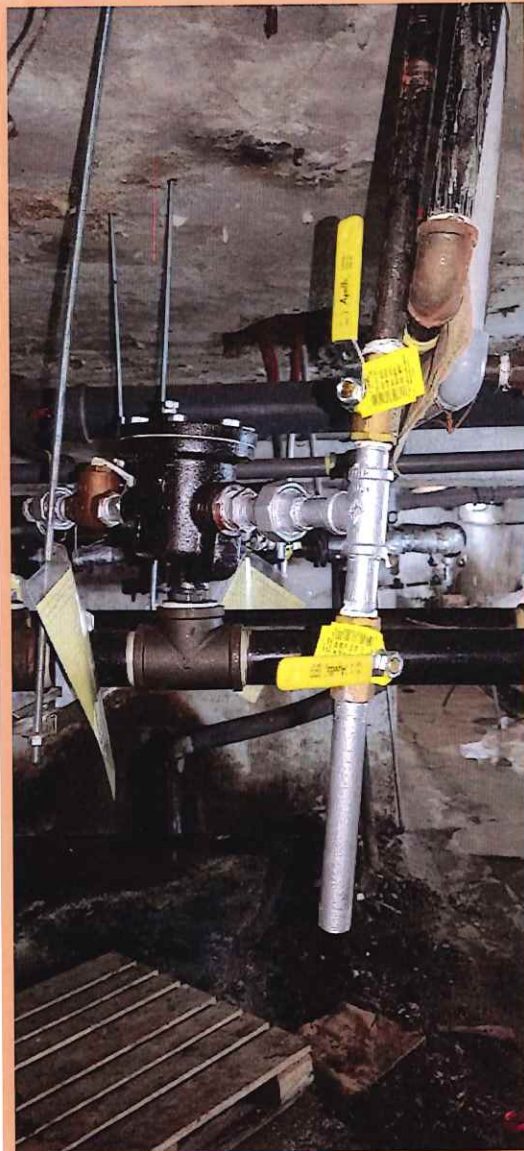
DETALLE: Instalación de trampas y válvulas para vapor
