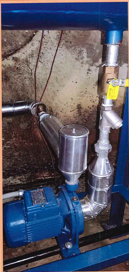
DETALLE: Bomba de impulsión del sistema de retorno de condensado
