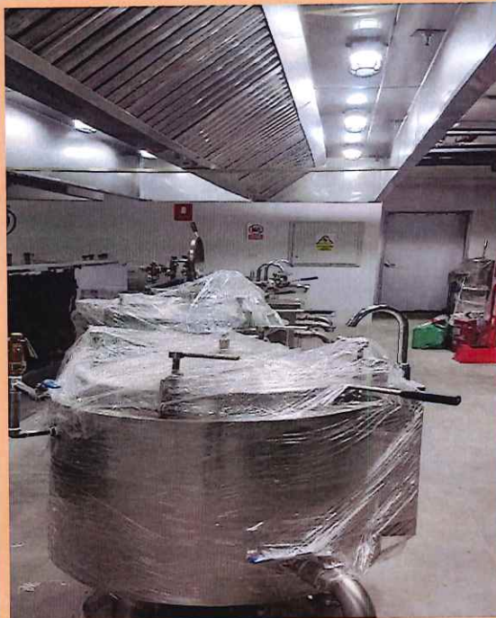
DETALLE: Marmitas a vapor y campana de extracción
