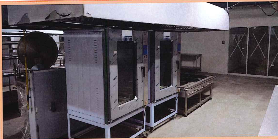
DETALLE: Hornos convectores a gas y cocina
