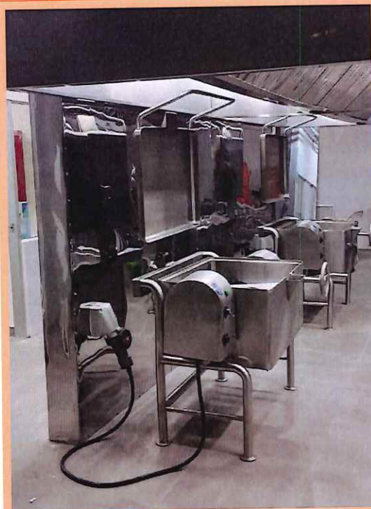
DETALLE: Sartenes eléctricos
