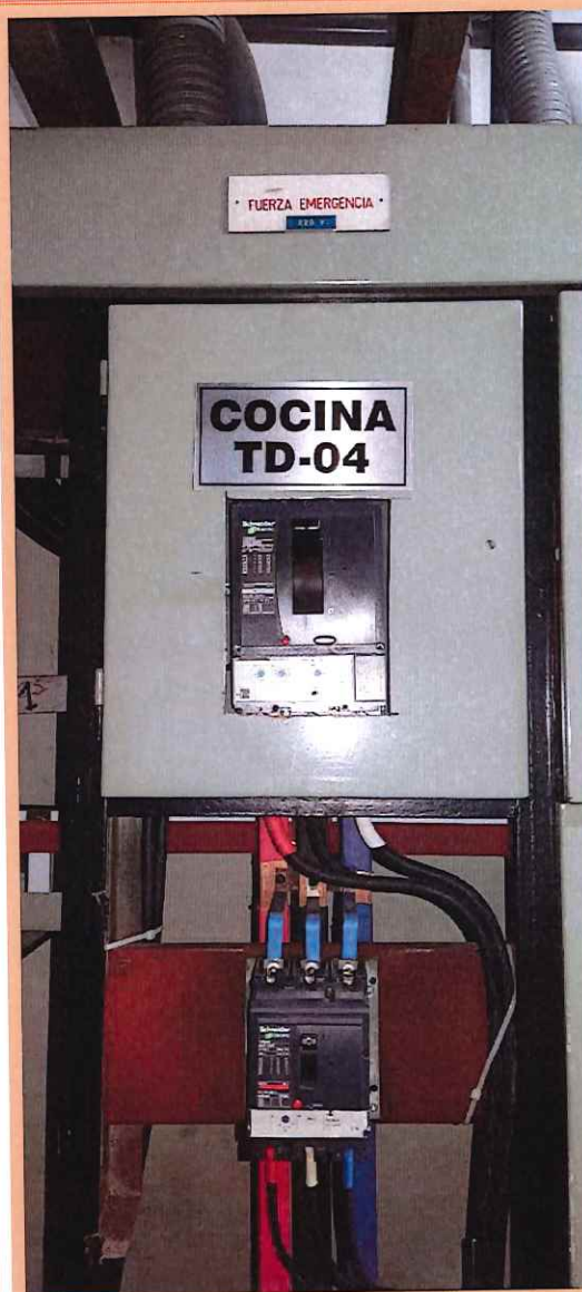
DETALLE: Barras de fuerza y llave interruptor instaladas
