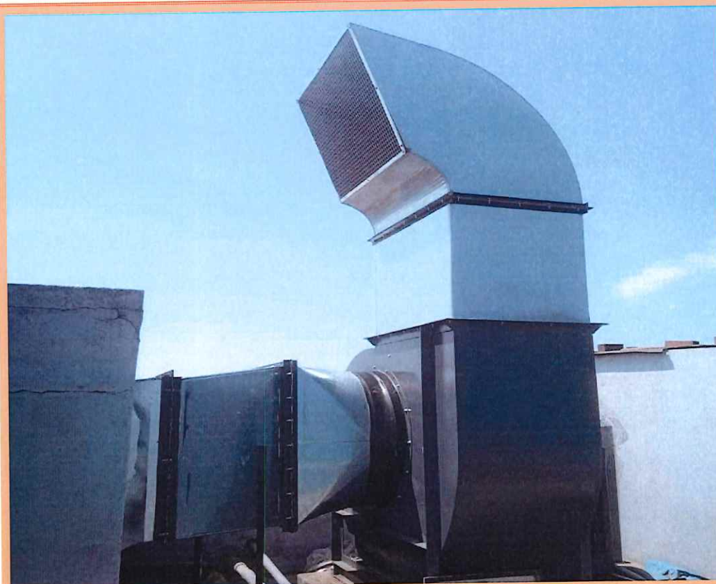
DETALLE: Sistema de extracción de la azotea
