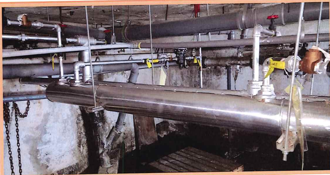
DETALLE: Tubería de retorno de condensado culminada LUGAR: Sótano 2
