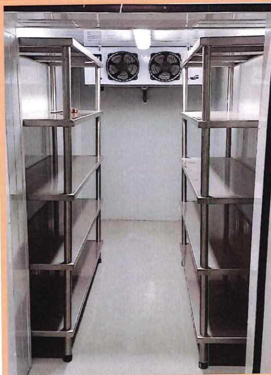
DETALLE: Presentación interna de las cámaras
