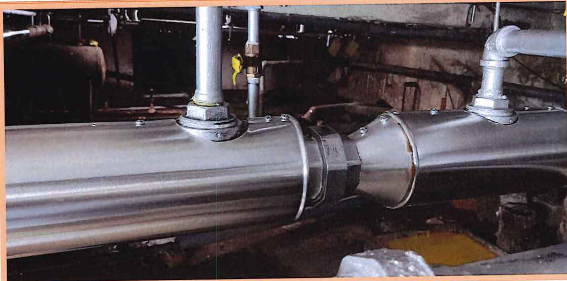
DETALLE: Forrado de tuberías de Fe Ne con chaqueta de aluminio LUGAR: Sótano 2
