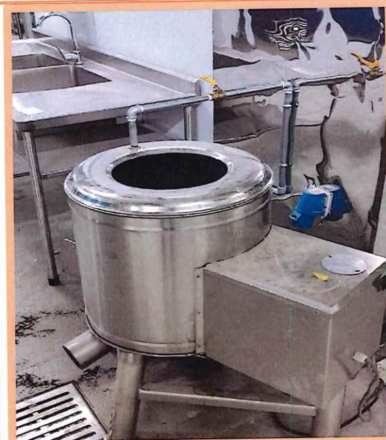
DETALLE: Colocación de punto de agua para peladora
